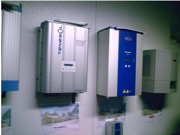
Modeles d'onduleurs dans le local technique de la plate-forme
