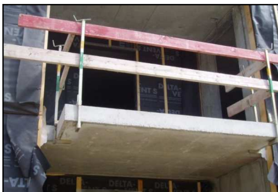
Dalle d'un balcon sur le bâtiment D
