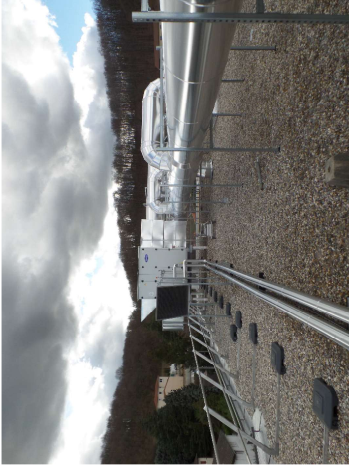
Installations de ventilation en toiture
