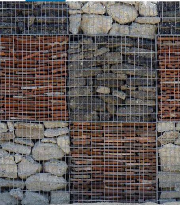
Court-circuit, St Martin d'Hères NA Architecture
