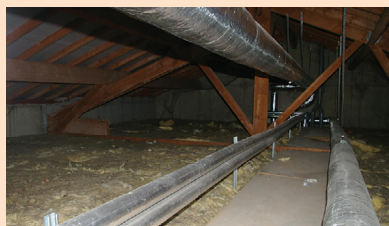
Tube de VMC dans l'espace non chauffé
