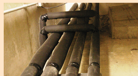
Calorifugeage des tuyaux de chauffage bien réalisé
