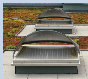
Développement de mousses sur les puits de lumière
