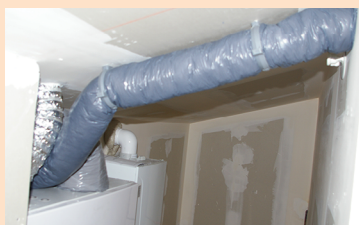
Gaine souple sensible à la diminution de diamètre au niveau des colliers de fixation
