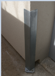
Protection des angles saillants de l'ITE à la sortie du local poubelle
