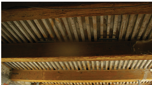
Plancher existant en bois présentant des problèmes de niveaux
