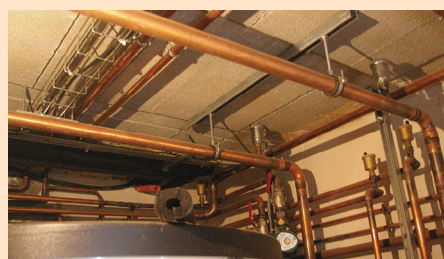
Tuyaux non isolés
