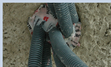
Passage de plusieurs gaines dans un trou
