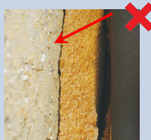
Manque de chevilles pour plaquer les deux couches de laine de bois contre le mur
