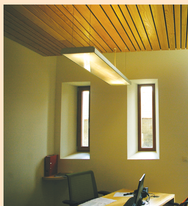
Luminaire fixe ne facilitant pas un réaménagement du bureau
