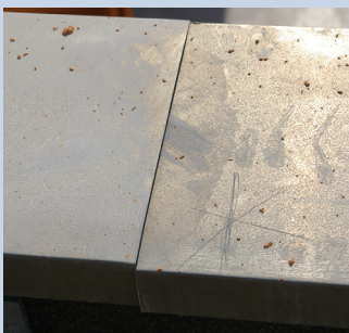
Défaut de pose des couvertines (pas de recouvrement des tôles)
