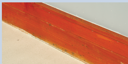
Développement de moisissures sur la menuiserie. Ponçées et repeintes à l'aide de peinture naturelle, les moisissures demeurent visibles
